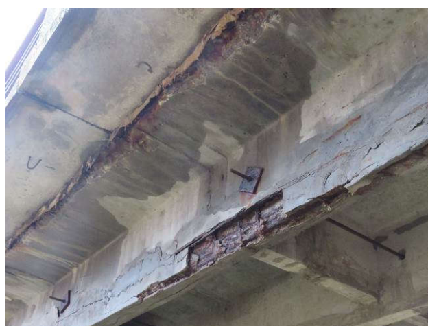
Размораживание бетона с оголением и коррозией рабочей арматуры ребра балки №6 пролета №7, замок консоли
