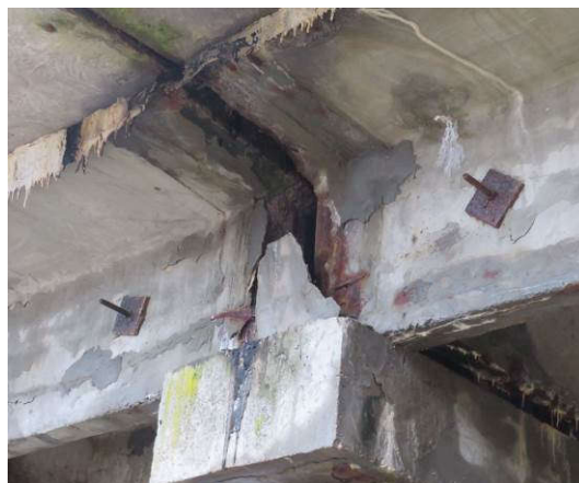
Скол торцов крайних балок на опоре №3
