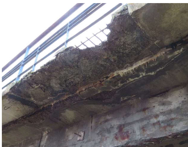
Размораживание бетона тротуарного блока и консоли плиты балки с оголением и коррозией арматуры в пролете №6 справа
