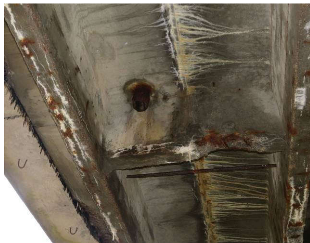
Размораживание, следы выщелачивания бетона, замокание балки №№1, 2 пролета №2, коррозия водоотводной трубки
